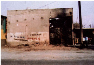
Figura 7.27. Daños causados por explosión, caso 2
