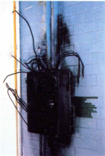
E. Tablero eléctrico quemado.
