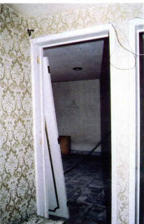
C. Entrada a una habitación donde se identifica una de las puertas desprendida en su origen.
