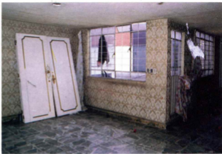
C. Daños en casa habitación.
