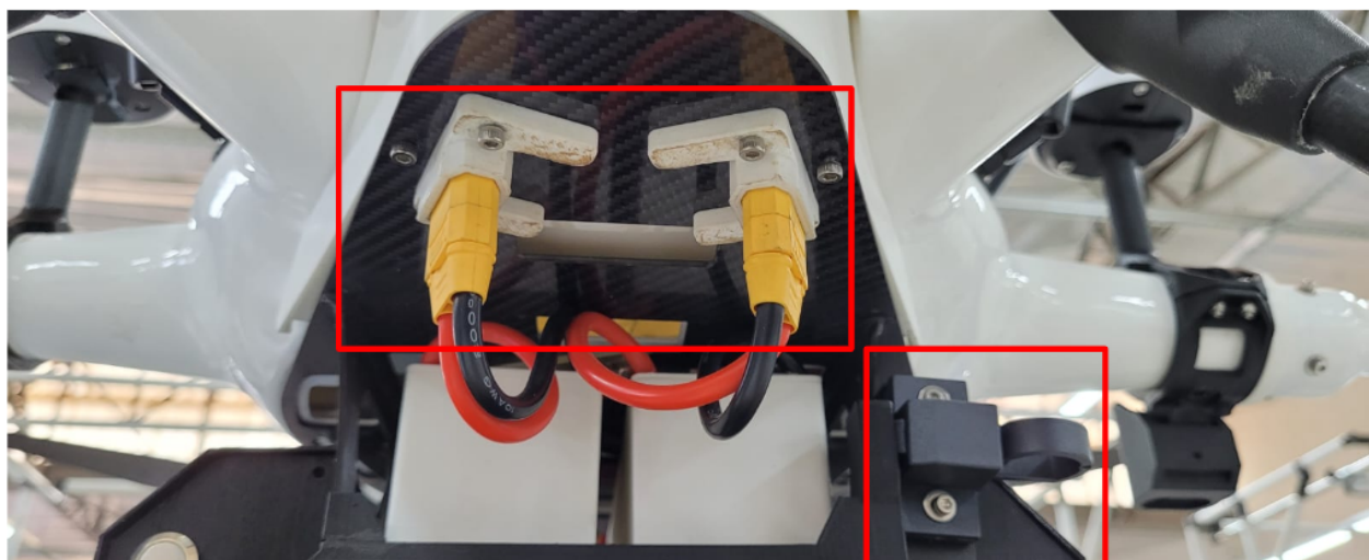
Figura 60: Cables conectados y batería bloqueada
